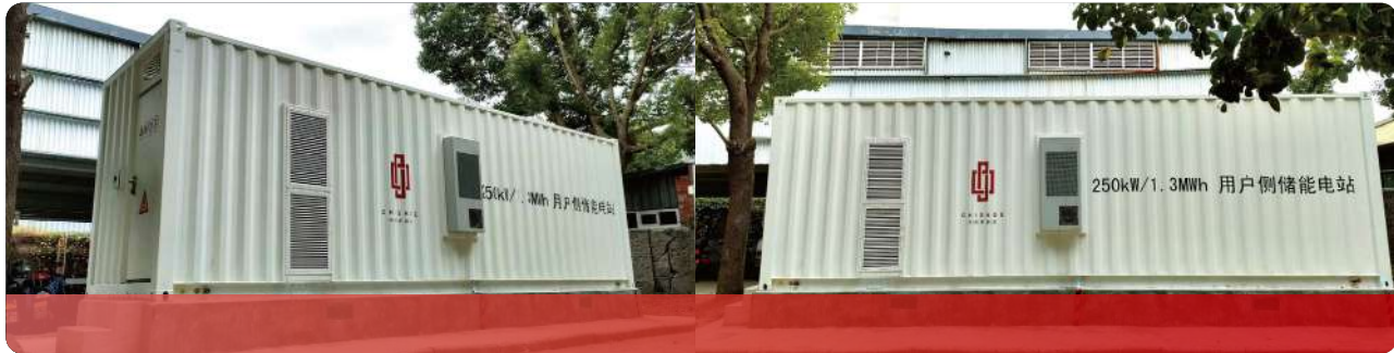
应用产品: CE-2501300 时间: 2021年11月 地点: 中国·宁波 容量: 250KW/1.3MWh
