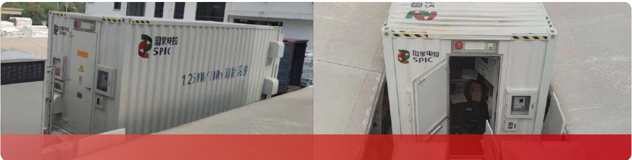
应用产品: CE-12503000 时间: 2022年12月 地点: 中国·湖州安吉 容量: 1.25MW/3MWh
