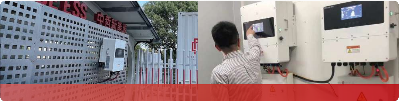
应用产品: 逆变器 --Mars-12G1-LE 电池--CE48100-R 时间: 2022年12月 地点: 中国·宁波 容量: 36KW/90KWh
